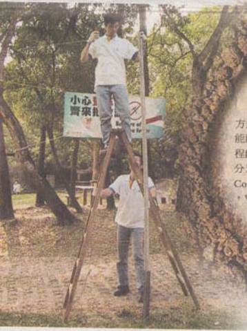
中電的員工每年都會在賽理沿途架起一些臨時供電設施，令樂施毅行者的檢查站得以設置電子設備，並為參賽者提供熱飲。
